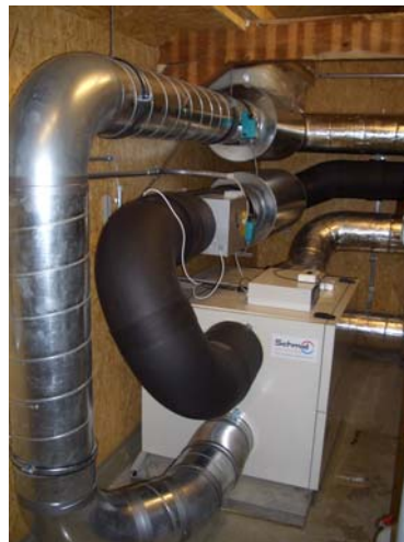
Zentrales Lüftungsgerät mit Wärmerückgewinnung
