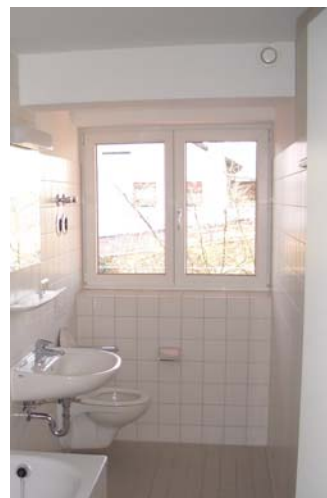
Entlüftung als Tellerventil Bäder und Küchen
