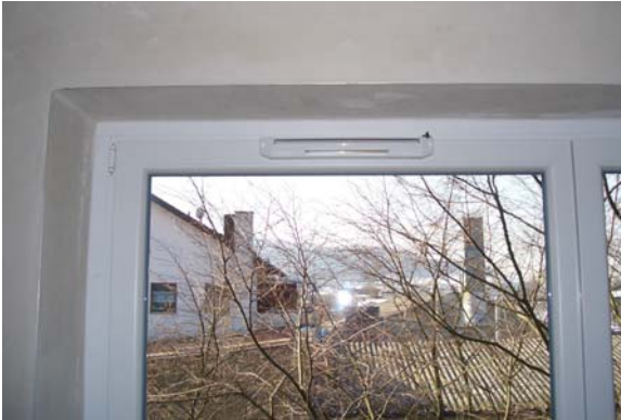
Zuluftspaltventil im Fensterflügel in Wohn- und Schlafräumen
